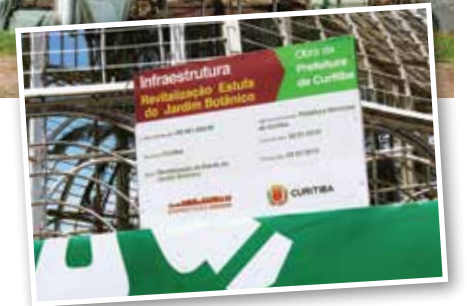
Estufa de vidro do Jardim Botânico passa por nova obra de revitalização enquanto os equipamentos continuam sem manutenção
